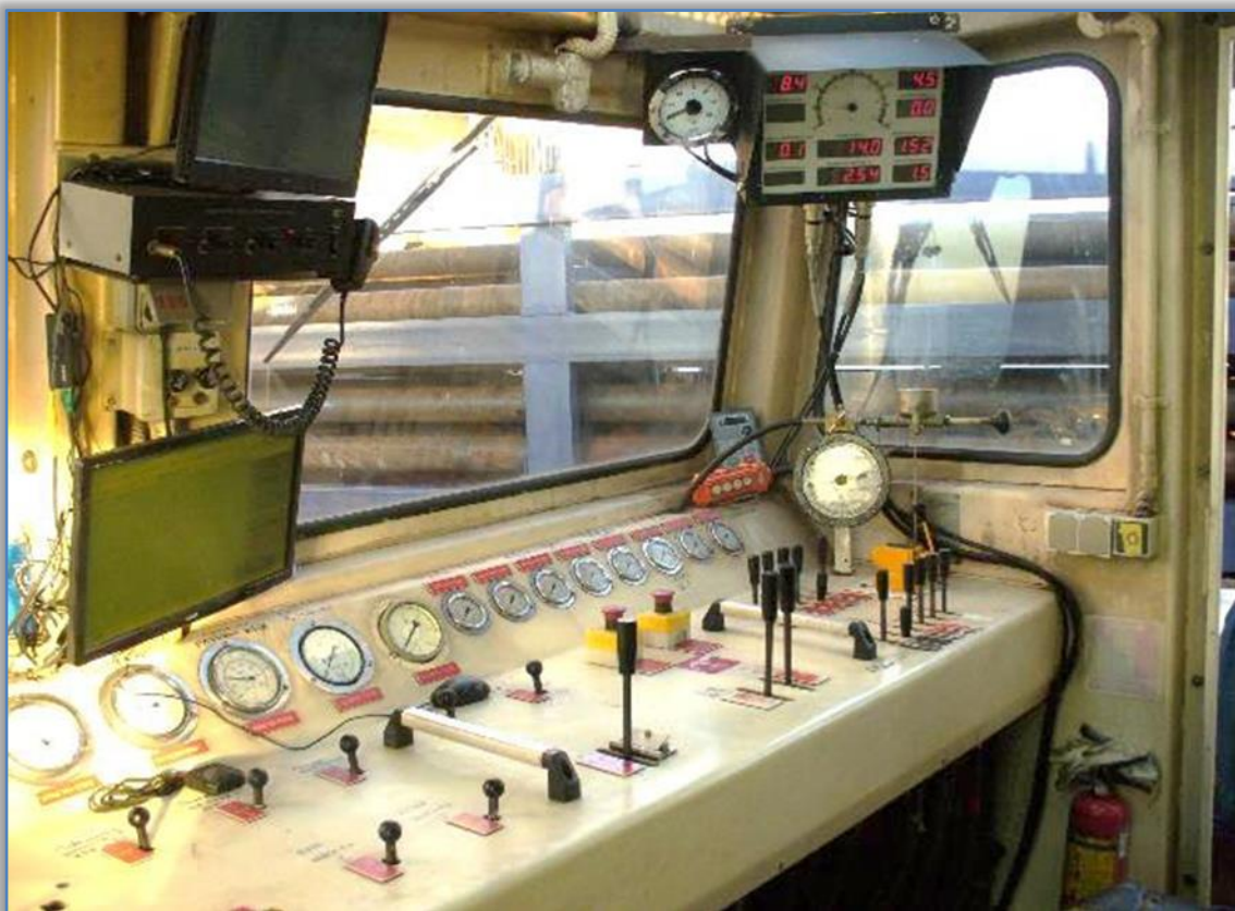
Панель управления буровой установкой
